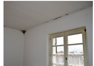
Hohe Luftfeuchtigkeit führt zu Kondensat in den Raumecken und somit zu Schimmel
